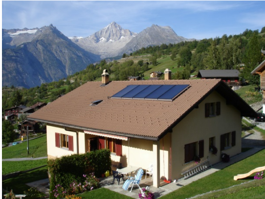
Solarwärme-Aufdachanlage auf Steildach, überragt Dachfläche um weniger als 20 cm und erfüllt somit die Vorgaben von Art. 32a Abs. 1 RPV. © Vesca / Walter Meier
