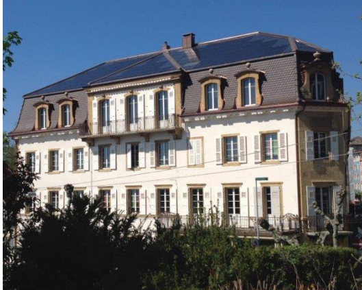
Hôtel des Associations, Neuchâtel, im Quartier du Tertre, ISOS-Inventar mit Erhaltungsziel A. Dachintegrierte Photovoltaikanlage mit 28 kW. © Schweizer Solarpreis 2015
