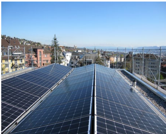
Aufgeständerte Flachdach-Photovoltaikanlage mit Ost-/Westausrichtung auf Wohngebäude. In den meisten Kantonen bewilligungspflichtig © Swissolar
